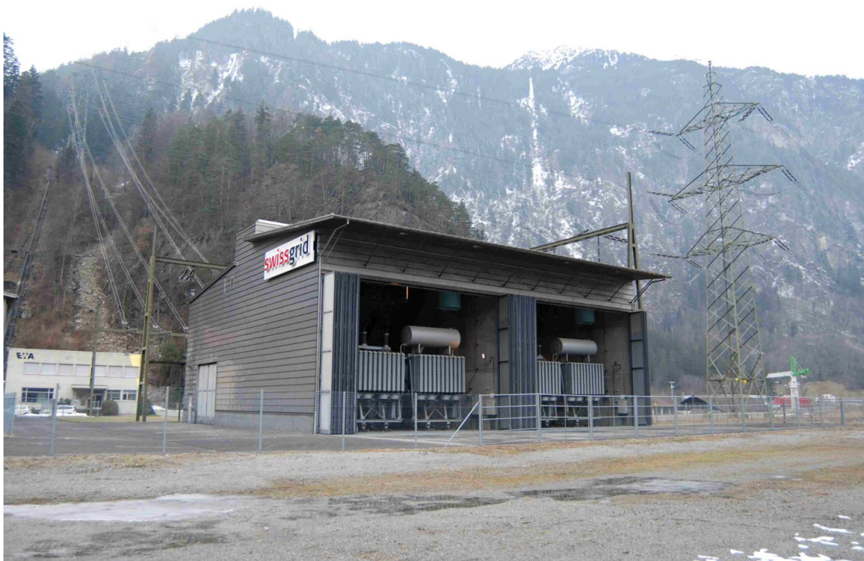
Das Unterwerk Plattischachen in Amsteg
